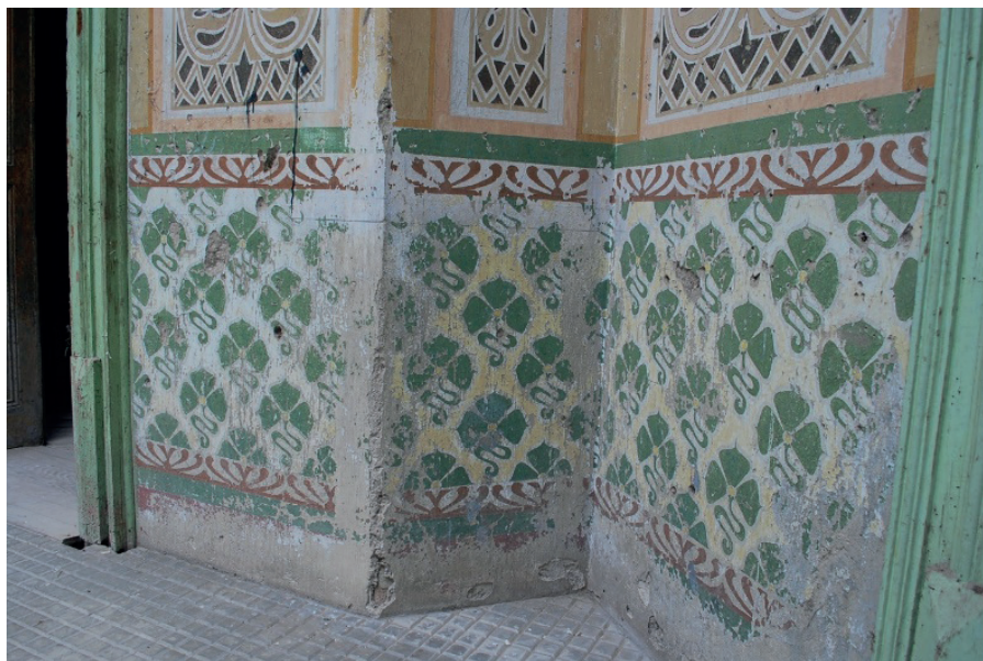
Detalle de la parte inferior de las paredes del pabellón central de la Hacienda de Santa Águeda.
