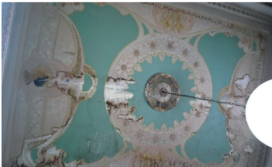
Pintura en el techo del zaguán en Avenida Reforma 725 esquina 9 Sur.
