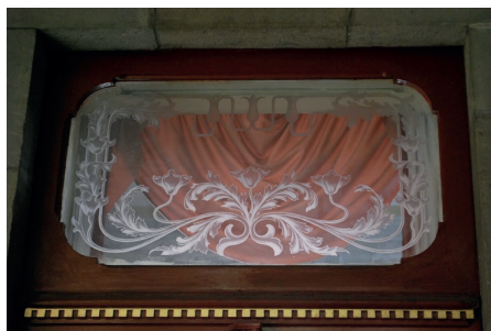
Dintel de la puerta en el patio en Avenida Reforma 725 esquina 9 Sur.
