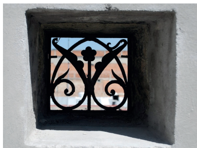
Respiradero de la fachada en Avenida Reforma 917.
