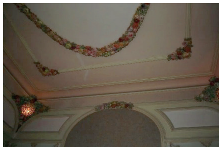
Escayola en las paredes y el techo de la quinta habitación Art Nouveau de la Casa Rangel.
