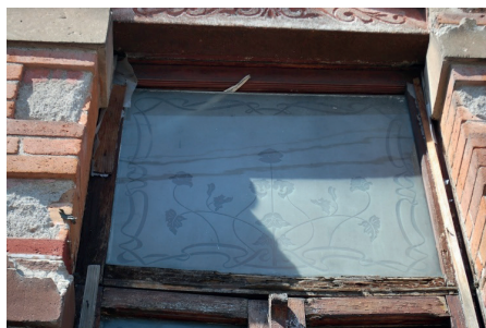
Dintel de un ventanal del torreón en 13 Sur 707.
