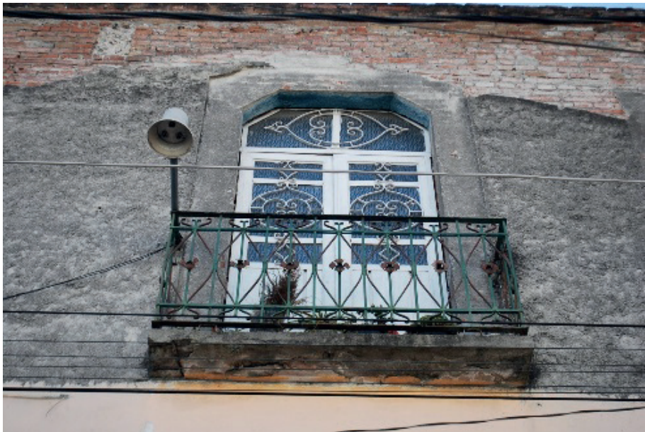
Barandilla de un balcón de 10 Poniente 1505.
