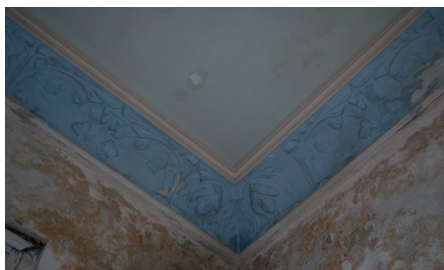
Techo de algunas habitaciones en Avenida Reforma 917 (Fotografía previa a la restauración).
